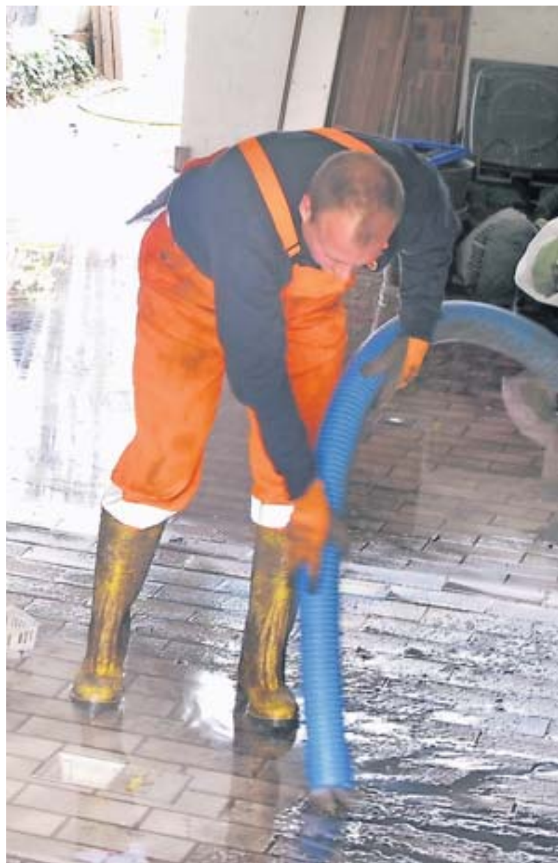
Durch das Abwasser, das in die Budberger Häuser eingedrungen ist, habe die Gefahr einer Infektion bestanden, sagen Betroffene. Das Kreisgesundheitsamt sagt zwar, dass Infektionen durch Fäkalien grundsätzlich möglich seien, schließt aber zum Beispiel Cholera kategorisch aus.
